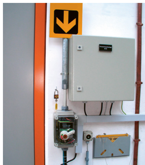
5 Anlageschalter (Kranschalter), der in der ausgeschalteten Stellung mit einem Vorhängeschloss gegen Einschalten gesichert werden kann.
