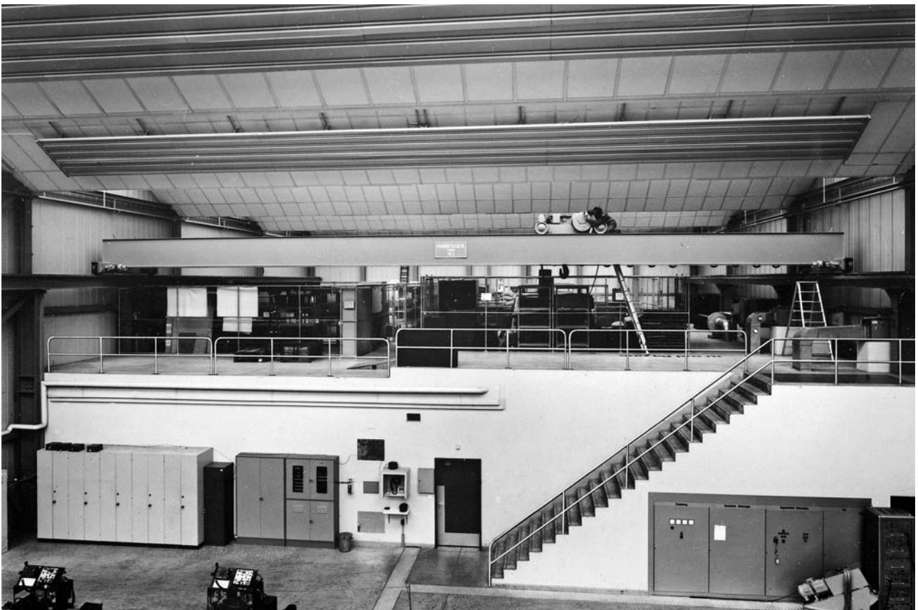
15 Zweiträgerkran, der von einer grossen Bühne aus unter Verwendung von Leitern mit Einhakvorrichtung und Bockleitern gewartet werden kann.
