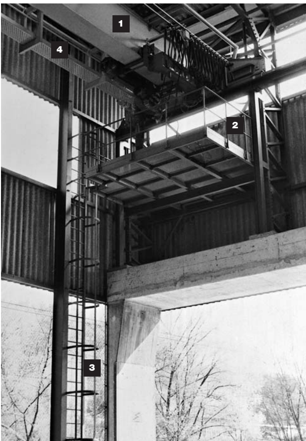
16 Einträgerkran mit Unterflanschlaufkatze. Zur Wartung der Unterflanschlaufkatze und des Hubwerks ist am Gebäude ein Podest angebaut. Von diesem aus können alle zu wartenden Teile erreicht werden. Der Abstand zwischen untersten festen Teilen an der Unterflanschlaufkatze und dem 1,1 m* hohen Geländer beträgt 0,5 m. Der Aufstieg auf das Podest erfolgt über eine Leiter mit Rückenschutz.
